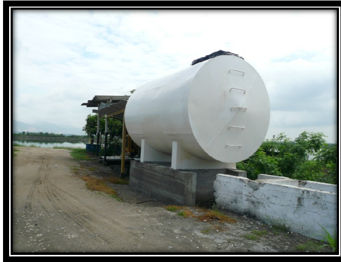
Figura 3.5 Tanque para combustible en la estación de bombeo # 2
