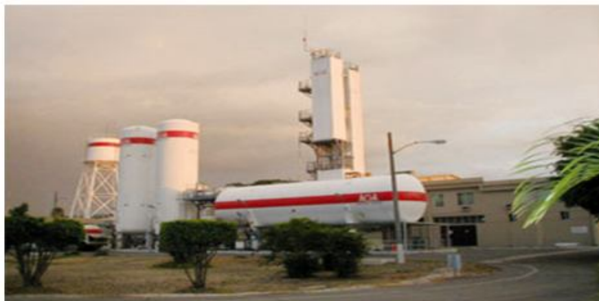
Figura No. 11 - Vista de la Planta de Gases (Guayaquil)
