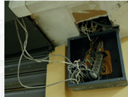
Figura 39: Instalaciones Eléctricas Interior del Centro Comercial.
