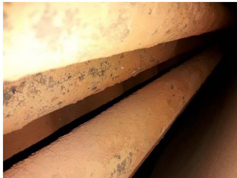
Figura 14. Tubería que presenta corrosión.
