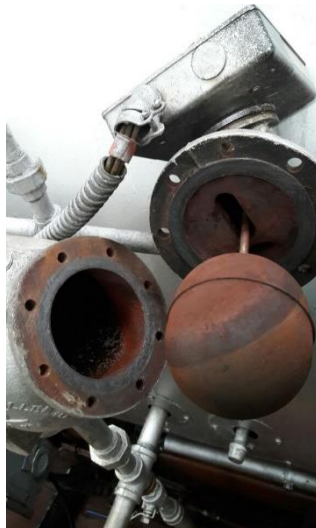
Figura 18. Boyas de control de nivel de agua.
