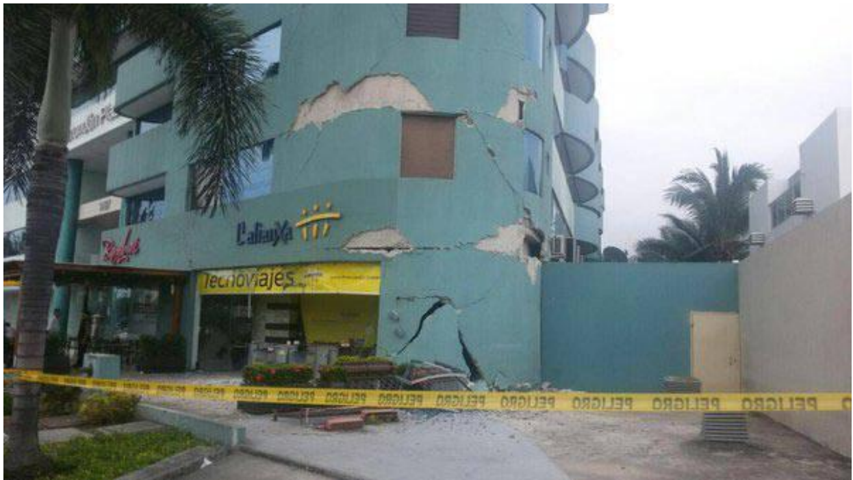
(El Universo, 2017) Foto anterior Edificio Samborondón Plaza luego de sismo.
