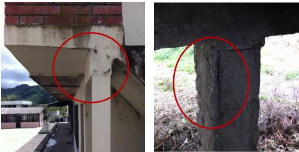
DEFICIENCIAS CONSTRUCTIVAS. ACERO SIN SU DEBIDO RECUBRIMIENTO
