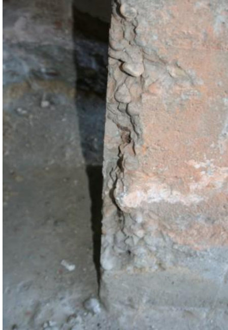
Oxidación en pilar (Abella, 2012)
