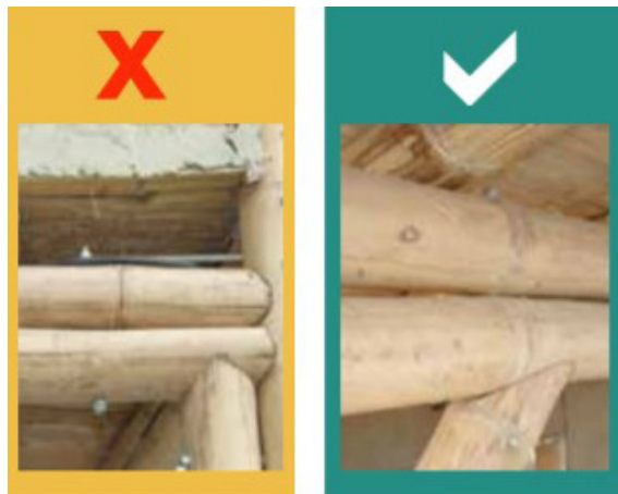
Figura 33: Aplastamiento y fisuras
