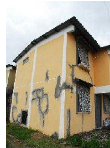
Villas de las etapas cuatro y cinco del plan habitacional del Municipio Mucho Lote presentan fisuras y filtraciones de agua en las paredes.
