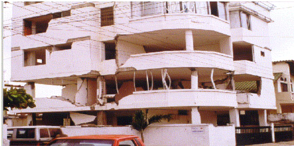
Gráfico # 6: Daños en edificio Karina
