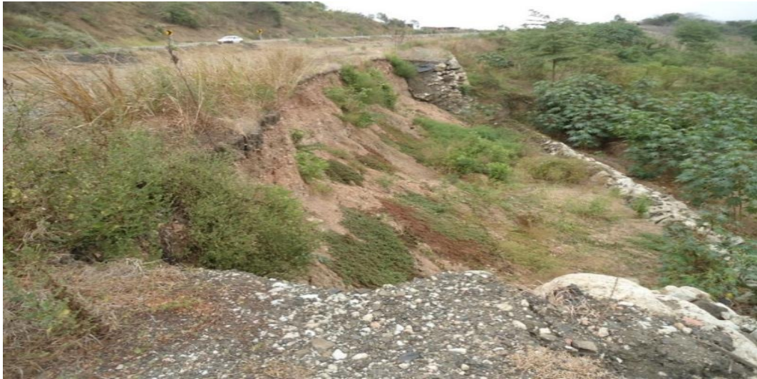
Foto 1.- Corona del deslizamiento El Junco.
