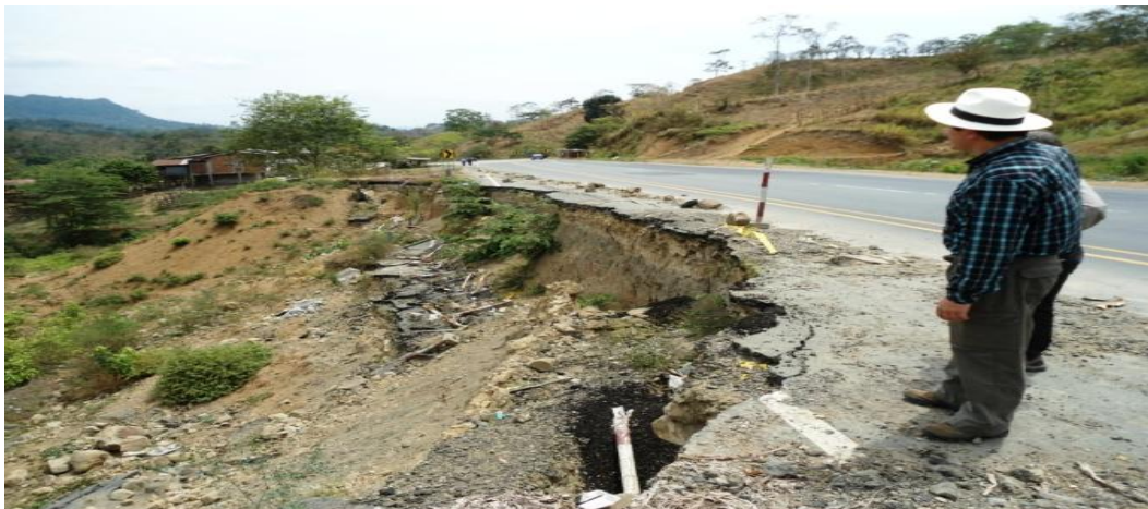
Foto 9.- Deslizamiento 2B de Pavón, abscisa 20+500.
