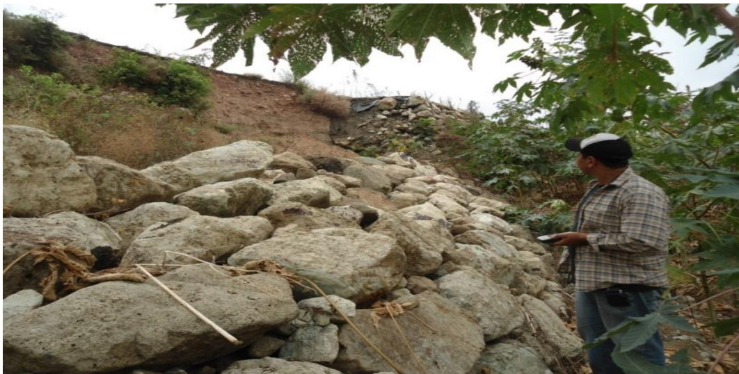
Foto 2.- Muro de piedras colapsado.
