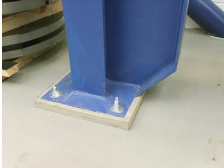
Imagen 7 Uso inapropiado de los pernos de anclaje.
