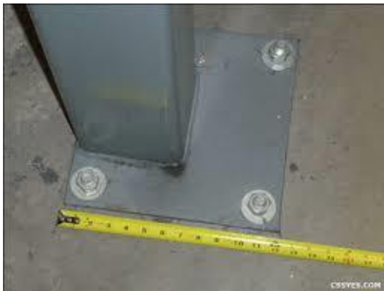
Imagen 6 Uso inapropiado de los pernos de anclaje, separación entre pernos y ubicación de la columna
