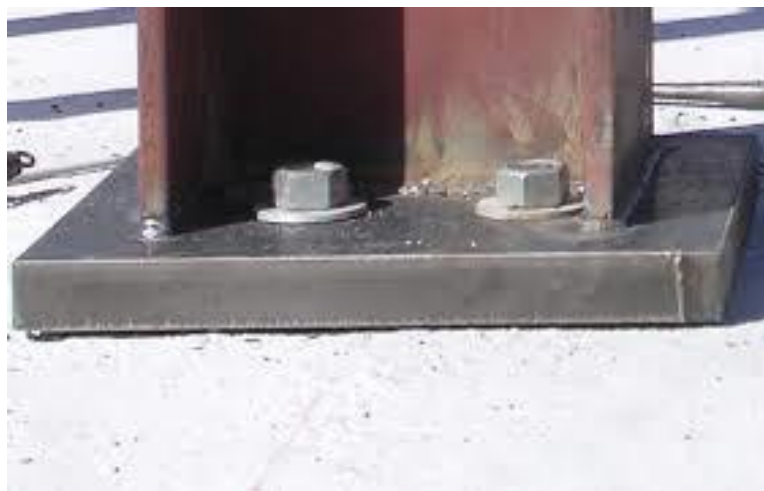
Imagen 8 Uso inapropiado de los pernos de anclaje.
