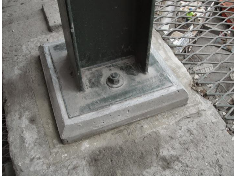
Imagen 5 Uso inapropiado de los pernos de anclaje.
