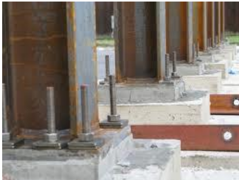
Imagen 4 Uso inapropiado de los pernos de anclaje.
