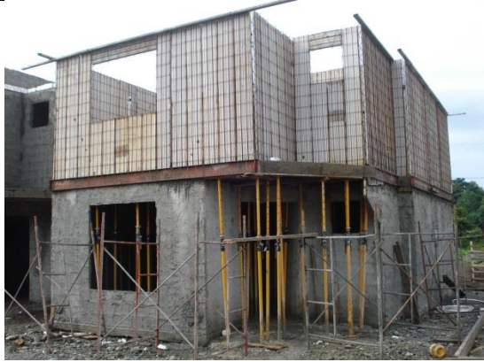
Ilustración 39: Paneles de pared. Fuente: Ing. Adolfo Chiriboga
