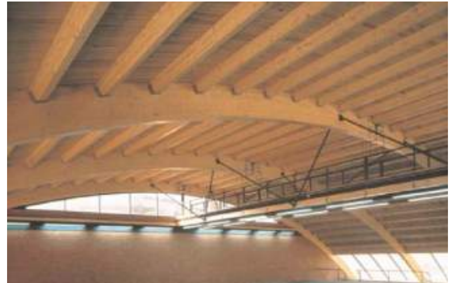
Gráfico 50 Complejo del Palacio de la Moncloa en Madrid estructura de madera laminada. Fuente: Tecnología de la madera aplicadas al diseño de estructuras.
